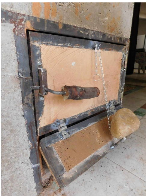
Porte du foyer clapet ouvert - E
