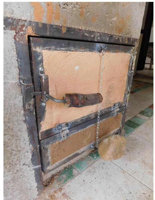
Porte du foyer clapet fermé - E
